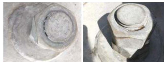
Рис. 5. Стык болта с гайкой в основании несущей конструкции не прокрашен. Объект-развязка у моста Бетанкура в Петербурге – только что сдан. Июнь 2018 г.
